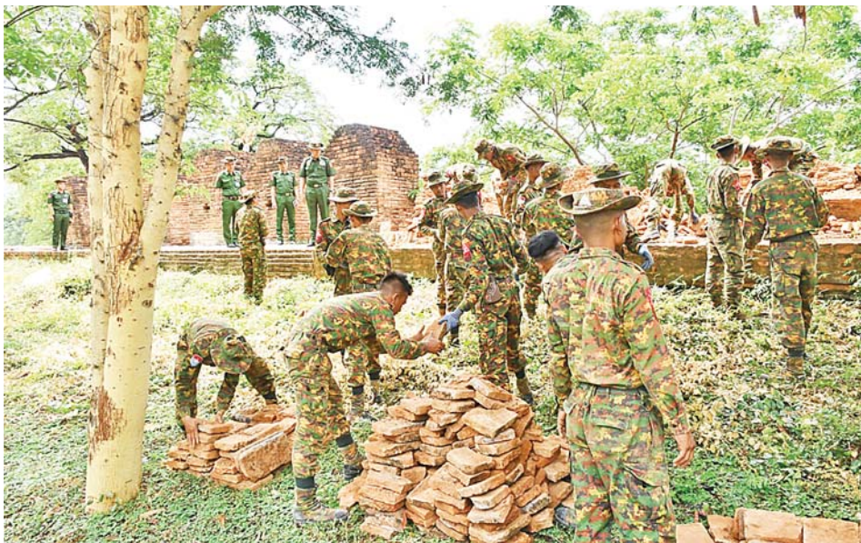
ကာကွယ်ရေးဦးစီးချုပ်ရုံး(ကြည်း)မှ ဒုတိယဗိုလ်ချုပ်ကြီးမျိုးမိုးအောင် မန္တလေးနန်းမြို့ရိုး၌ ငလျင်ဒဏ်ကြောင့် ပြိုကျပျက်စီးခဲ့သည့်အပျက်အစီးများအား ဖယ်ရှားရှင်းလင်းရေးဆောင်ရွက်နေမှုကို ကြည့်ရှုစစ်ဆေးစဉ်။
