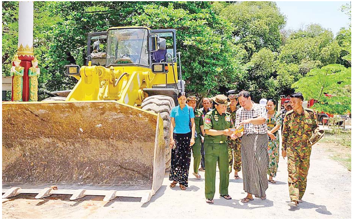
ကာကွယ်ရေးဦးစီးချုပ်ရုံး(ကြည်း)မှ ဒုတိယဗိုလ်ချုပ်ကြီးစိုးတင့်နိုင် မန္တလေးမြို့၊ အမရပူရမြို့နယ်ရှိ ကျောက်တော်ကြီး မြတ်စွာဘုရား၌ ငလျင်ဒဏ်ကြောင့် ပြိုကျပျက်စီးခဲ့သည့် အပျက်အစီးများအား ဖယ်ရှားရှင်းလင်းနေမှုကို ကြည့်ရှုစစ်ဆေးစဉ်။
