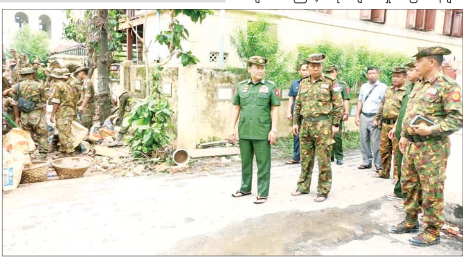
ကာကွယ်ရေးဦးစီးချုပ်ရုံး(ကြည်း)မှ ဒုတိယဗိုလ်ချုပ်ကြီး စိုးတင်နိုင် ချမ်းမြသာစည်မြို့နယ် ကျွန်းလုံးဥသျှောင်ရပ်ကွက်ရှိ ဒက္ခိဏာရာမဘုရားကြီးကျောင်းတိုက်အတွင်း ငလျင်ဒဏ်ကြောင့် ပြုကျပျက်စီးခဲ့သော သာသနိကအဆောက်အအုံများအား ဖယ်ရှားရှင်းလင်းနေမှုကို ကြည့်ရှုအေးပေးစဉ်။
