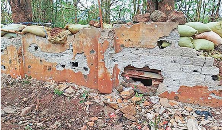
အဆောက်အအုံအုတ်တံတိုင်းများဖောက်၍ ပစ်ကျင်း/ခံစစ်ပြုလုပ်ထားမှုမှတ်တမ်း ဓာတ်ပုံ။
