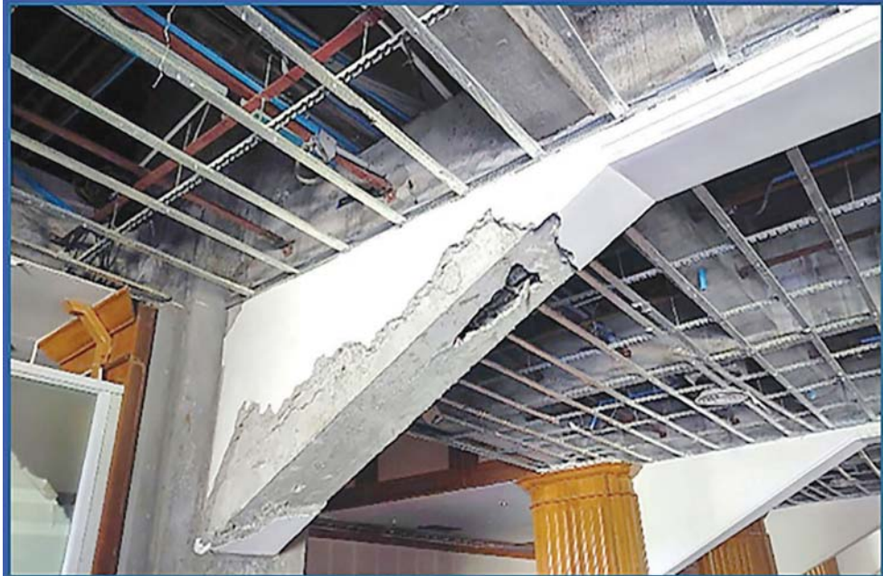
ဧည့်သည်တော်စင်မြင့်အောက်ရှိ Inclined Cantilever Beam ပျက်စီးမှု
