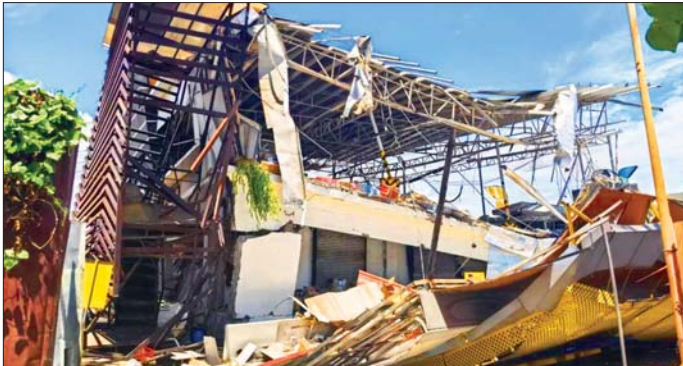
လျှင်လှုပ်ခတ်မှုကြောင့် ဖိလစ်ပိုင်နိုင်ငံ ဂျင်နရယ်ဆန်းတို့စံမြို့၌ အဆောက်အအုံတစ်ခု ပြိုကျပျက်စီးနေသည်ကို ဇွန် ၁၀ ရက်က တွေ့ရစဉ်။
